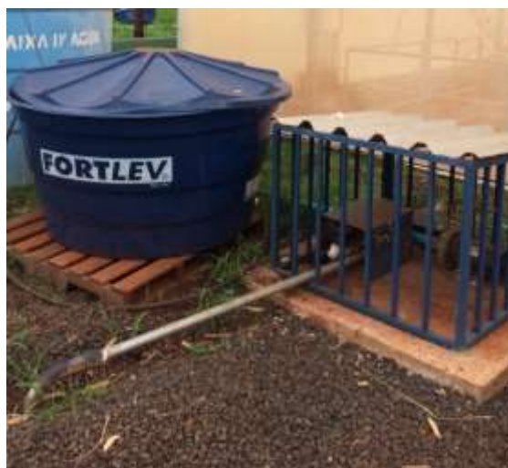
Figura 4. Bomba de ar do sistema de aquaponia.
